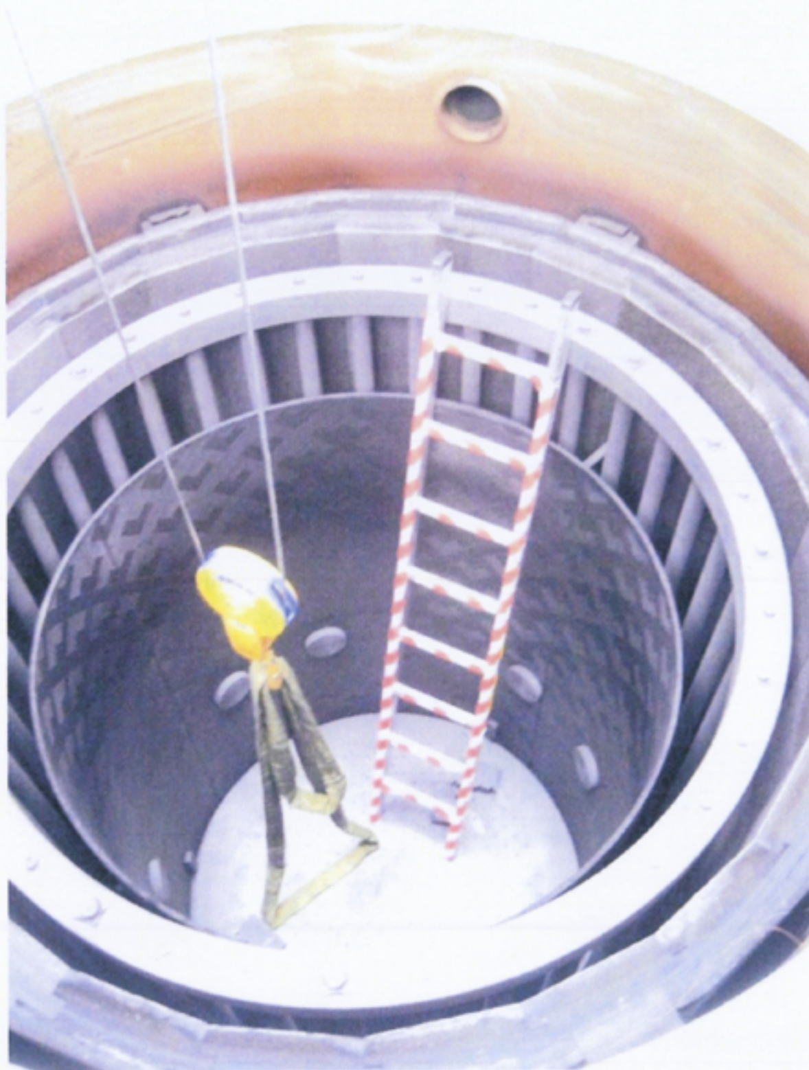
Foto 6: slachtoffers zijn aangetroffen op bodem reinigingsreactor PUR 9. Ten tijde van het ongeval stond deze ladder ongeveer zo opgesteld in de reactor en hing de gele hijsband aan de bovenloopkraan ongeveer op deze wijze ook in de reactor. De bodemdeksel was gesloten.
