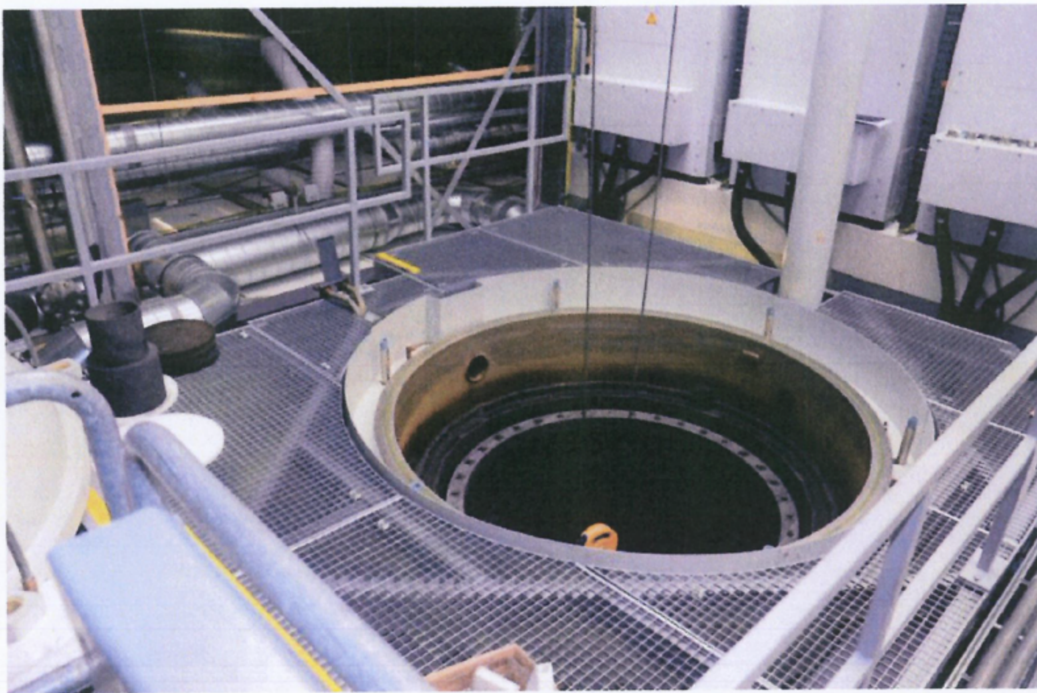
Foto 8: geopende bovenzijde reinigingsreactor PUR 9. Hijshaak van de bovenloopkraan hangt in de reactor. Links ervan enkele onderdelen. Geen afscherming tegen valgevaar aanwezig.
